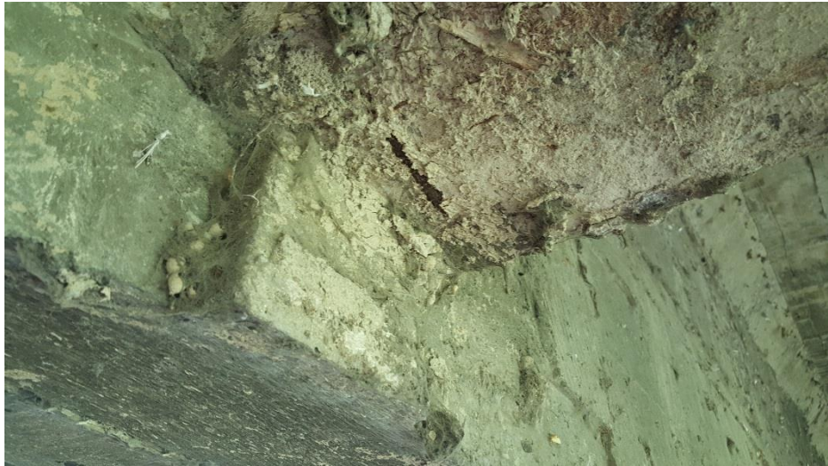
Fotografía 4.25: Estado actual, diafragmas del tramo 1. Fuente: Autores.
