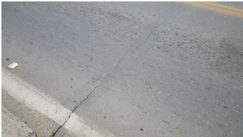
Fotografía 4.17: Fisuras en carpeta asfáltica.
