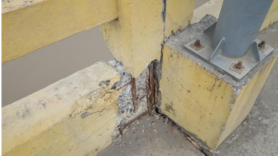
Fotografía 4.29: Estado actual, barandas peatonales. Fuente: Autores.
