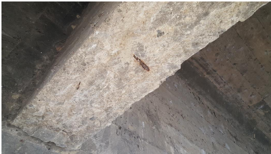
Fotografía 4.26: Estado actual, diafragmas del tramo 4. Fuente: Autores.
